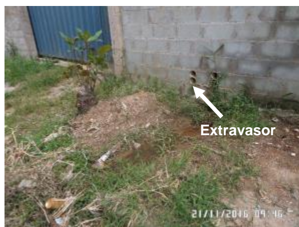
Figura 3.35 – Extravasor de água da propriedade particular para a rua (21/11/2016)
