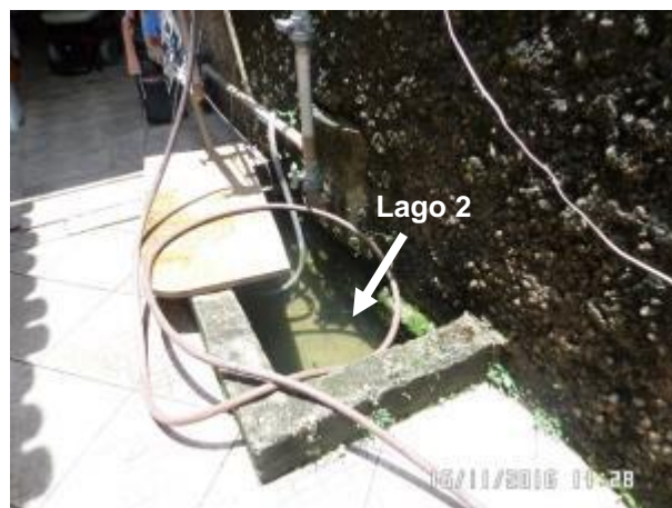
Figura 3.27 – Lago 2: Bombeamento de água para o uso doméstico (16/11/2016)
