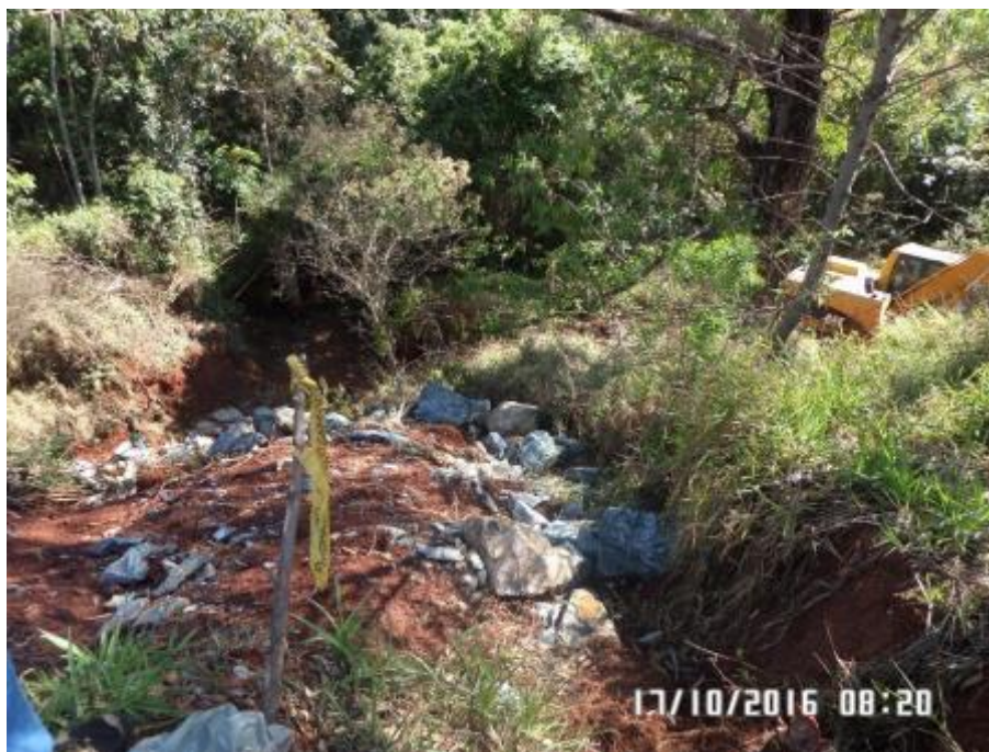
Figura 3.14 – Atividade erosiva às margens da BR-040 (17/10/2016)
