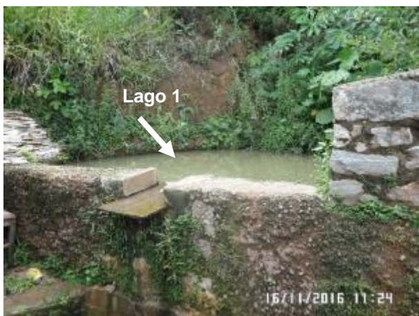
Figura 3.26 – Lago 1: Extravasamento de água (16/11/2016)
