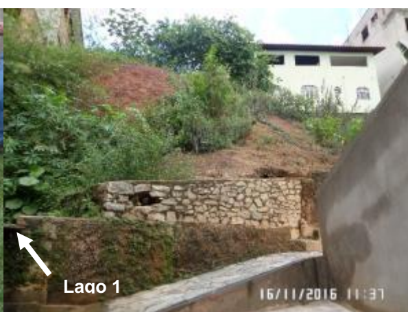
Figura 3.29 – Ocorrência de erosão a montante do Lago 1 (16/11/2016)
